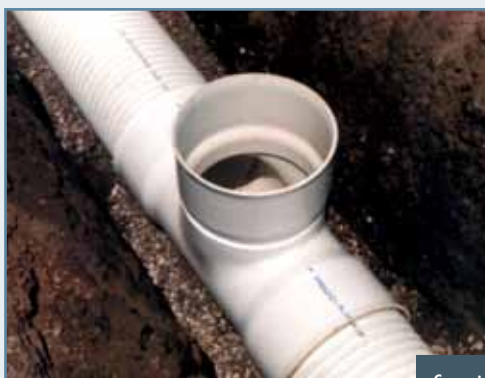
Conexiones SDR 35 en una tubería A-2000
